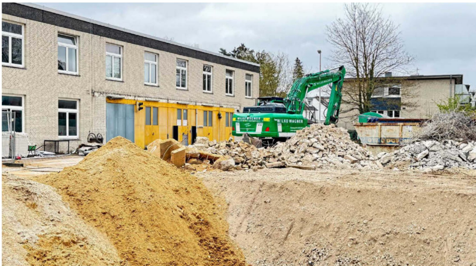
Am ehemaligen Postgebäude im Heisterweg gegenüber dem Schenefelder Rathaus haben die Abrissarbeiten begonnen. WOHNUNGSVEREIN HH V. 1902
